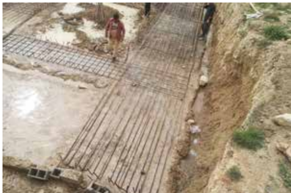
شکل - ۶ : پی‌سازی در درون زه آب بدون هیچ‌گونه چاره‌اندیشی برای مسائل بعدی آن
