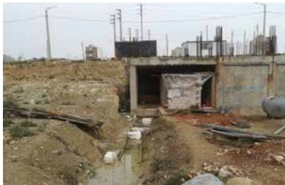
شکل - ۵ : زه آب به صورت چشمه از درون پی‌سازی ساختمان
