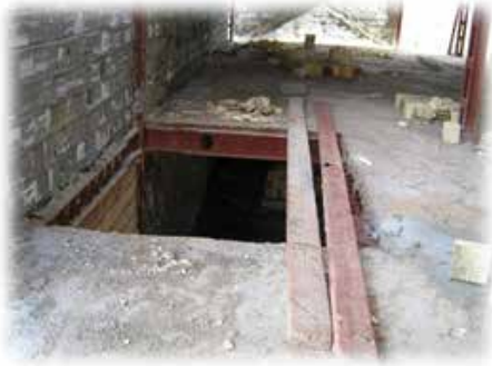
(پوشش نامناسب حفره‌ی آسانسور)
